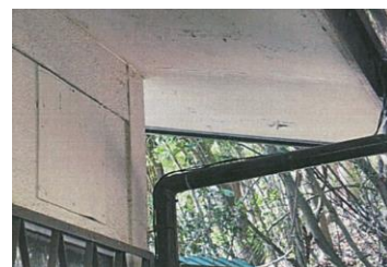
軒天井仕上の劣化
