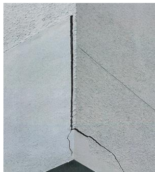
外壁のひび割れ
