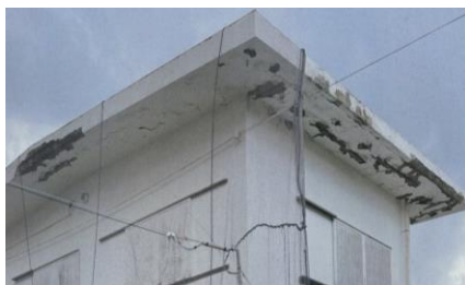
軒の剥落・露筋（RC造）
