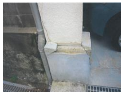
S造基礎の破損
