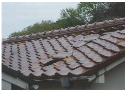
屋根瓦の剥落
