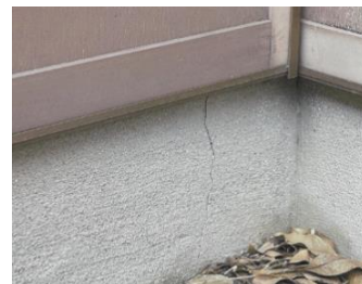
基礎の軽微なひび割れ
