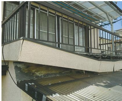
バルコニーの破損
