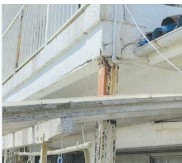
支柱部の破損
