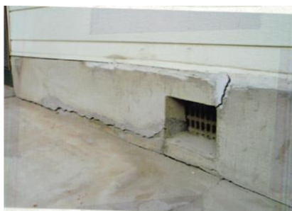
基礎のひび割れ
