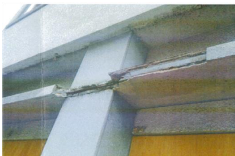
外壁の剥落 (RC造)
