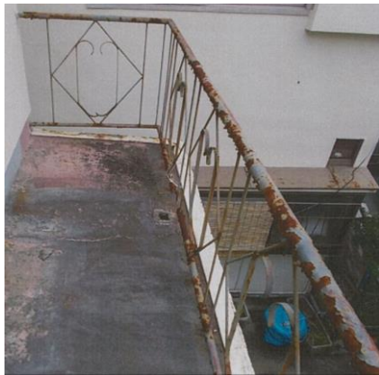
バルコニーの腐朽
