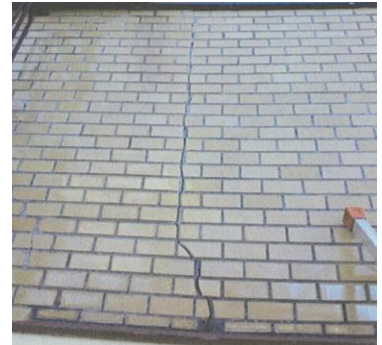
外壁タイルのひび割れ
