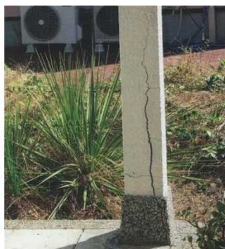
柱のひび割れ
