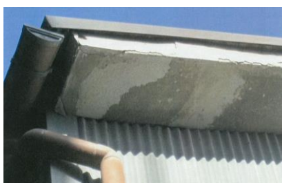
軒天井仕上げ剥落
