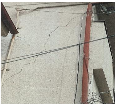
外壁のひび割れ
