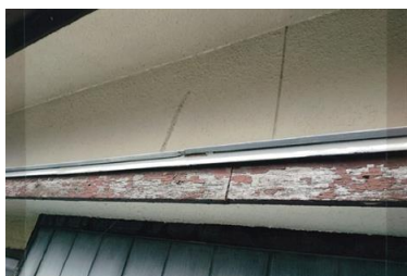
底の塗材剥がれ
