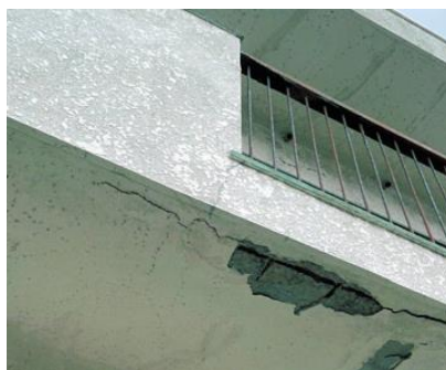
バルコニーの露筋（RC造）
