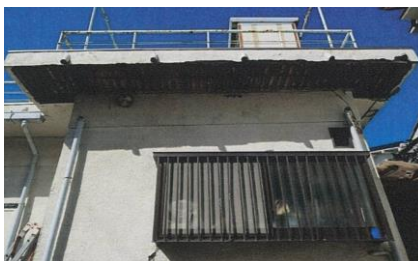
軒天井材の腐食落下（軽量鉄骨造）
