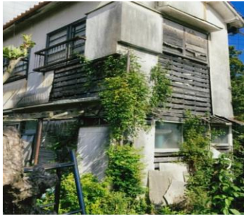
外壁の剥落・下地露出
