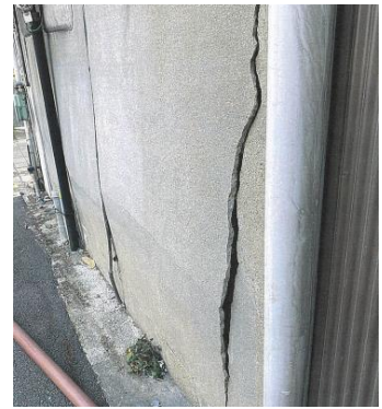
外壁のひび割れ・浮き
