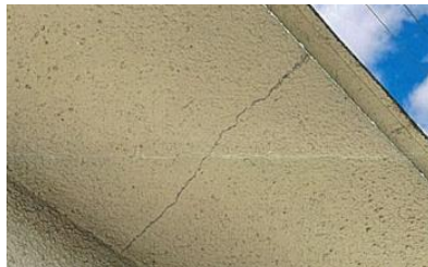
軒天の軽微なひび割れ
