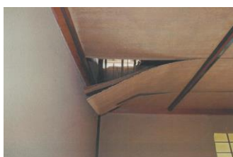
外壁破損による室内状況
