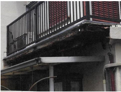
バルコニーの剥落
