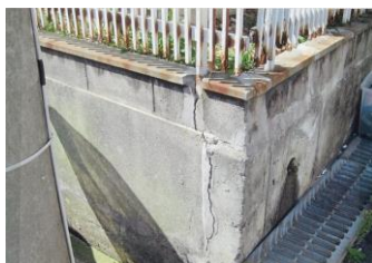
擁壁・塀のひび割れ
