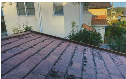
屋根材の腐朽（石綿セメント板）
