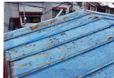
屋根材の腐朽（金属葺材）
