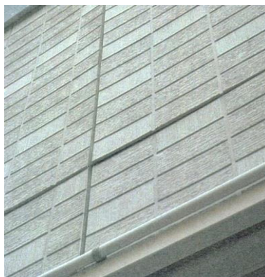
外装材の浮き
