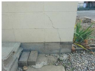
コンクリートブロック塀のひび割れ
