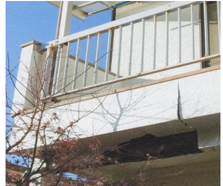
バルコニー部の破損・剥落
