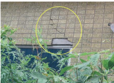
外壁タイルの剥落・浮き
