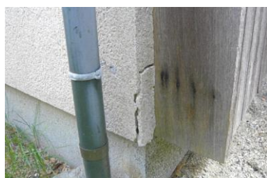
外壁の小破損
