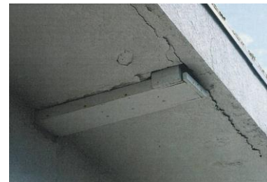
軒天井のひび割れ（軽量鉄骨造）
