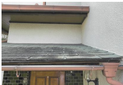
屋根材の腐朽（石綿セメント板）
