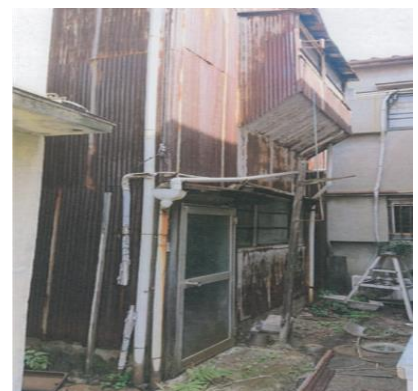
金属板の錆による腐朽
