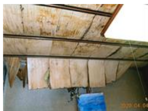
屋根破損による室内状況
