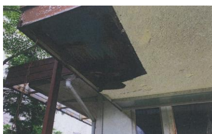
軒天井材の剥落
