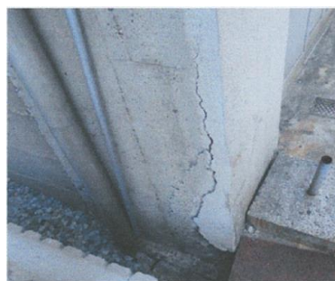
柱のひび割れ (RC造)
