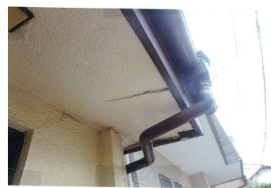
軒天井材のひび割れ
