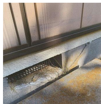
基礎のひび割れ
