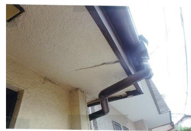
軒天井材のひび割れ
