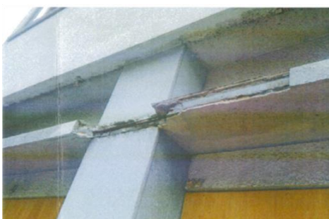
外壁の剥落（RC造）
