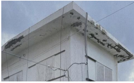
軒の剥落・露筋（RC造）
