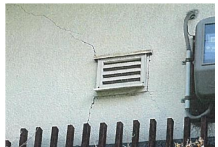
外壁のひび割れ
