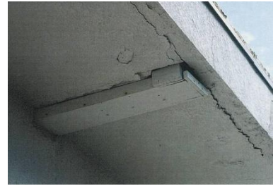
軒天井のひび割れ（軽量鉄骨造）
