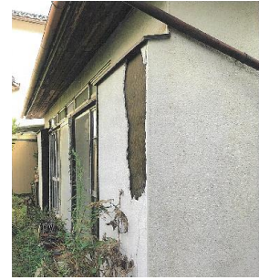
外壁仕上げ材の剥落
