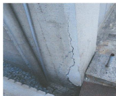
柱のひび割れ（RC造）
