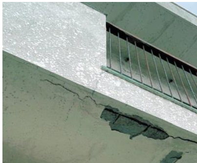
バルコニーの露筋 (RC造)
