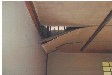
外壁破損による室内状況
