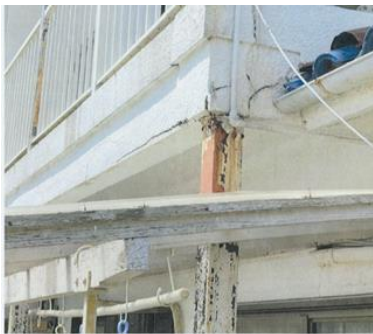
支柱部の破損
