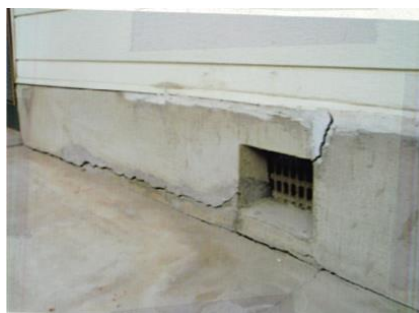
基礎のひび割れ
