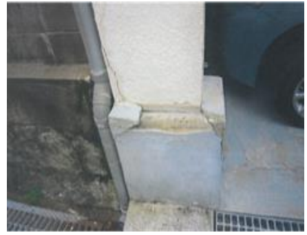
S造基礎の破損
