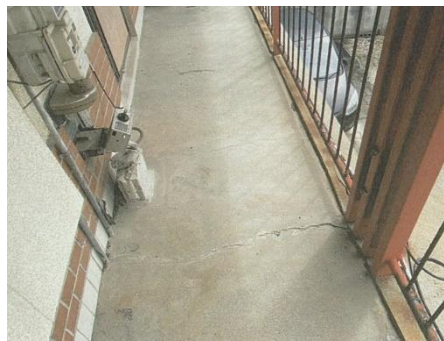
外廊下の床のひび割れ
