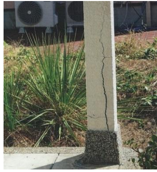
柱のひび割れ
