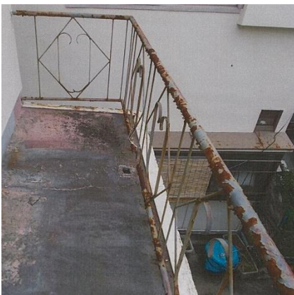
バルコニーの腐朽
