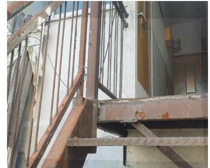
屋外階段鉄部の腐食
