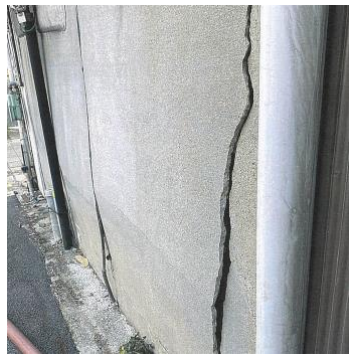
外壁のひび割れ・浮き
