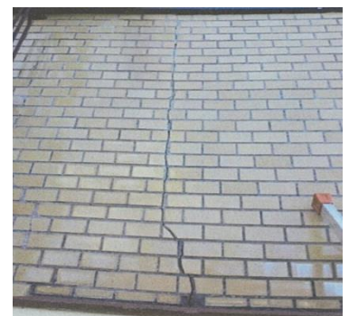
外壁タイルのひび割れ
