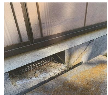
基礎のひび割れ
