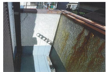
バルコニー腰壁のひび割れ・腐食
