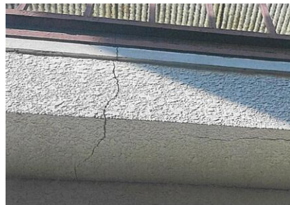
バルコニー軒先のひび割れ
