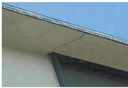
軒天井のひび割れ
