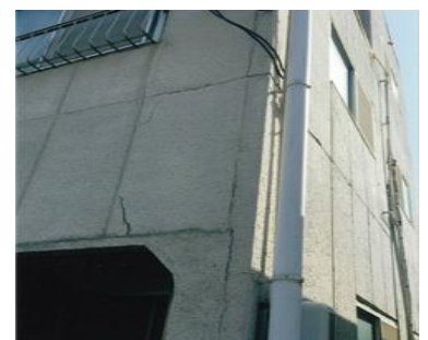
外壁（ALC板）のひび割れ（鉄骨造）
