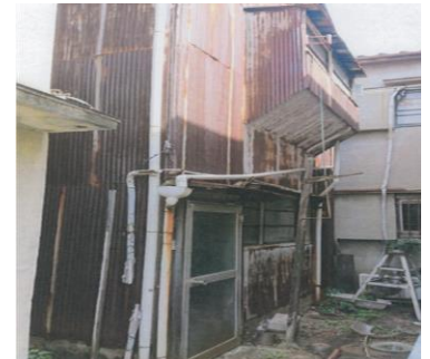
金属板の錆による腐朽
