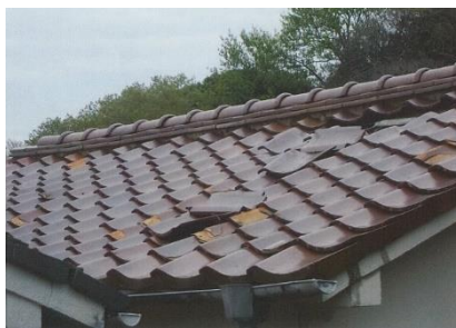
屋根瓦の剥落・ずれ
