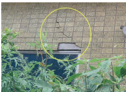
外壁タイルの剥落・浮き
