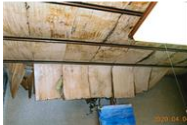
屋根破損による室内状況
