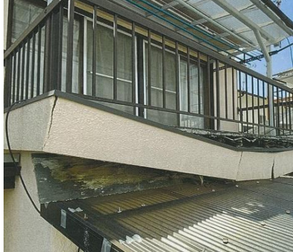
バルコニーの破損
