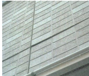
外装材の浮き
