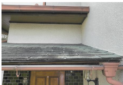
屋根材の腐朽 (石綿セメント板)
