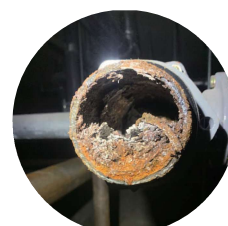
給排水設備の老朽化
