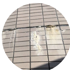
外壁タイル ・シーリングの汚損
