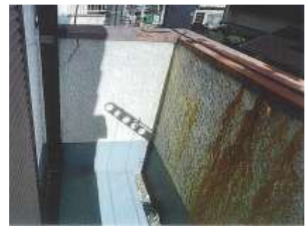
バルコニー腰壁のひび割れ・腐食
