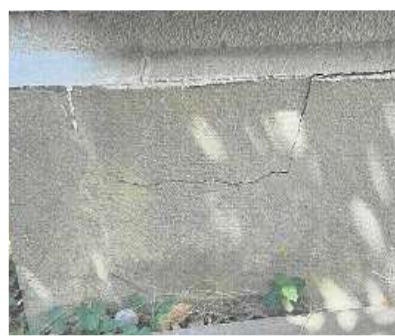
基礎のひび割れ
