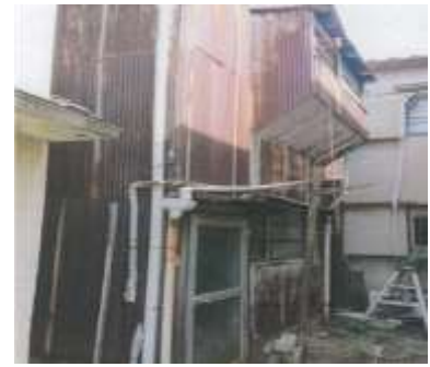
金属板の錆による腐朽
