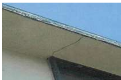
軒天井のひび割れ
