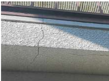
バルコニー軒先のひび割れ
