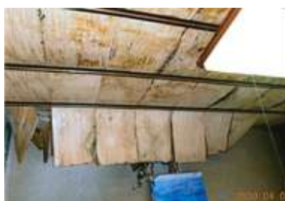
屋根破損による室内状況
