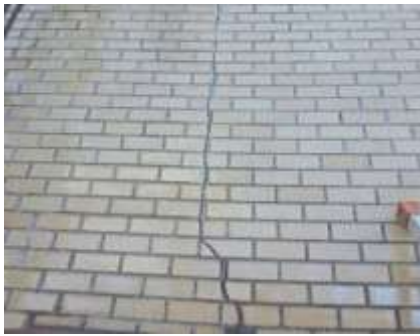
外壁タイルのひび割れ
