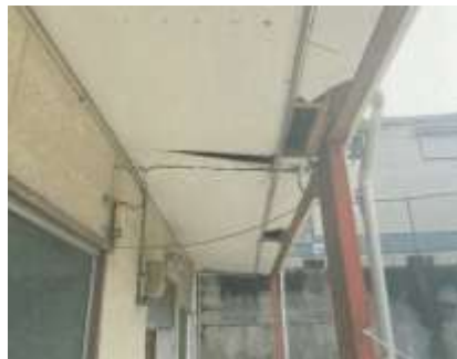
外廊下天井の剥落
