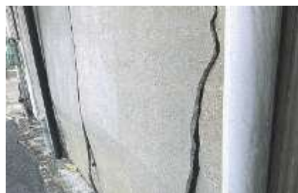
外壁のひび割れ・浮き
