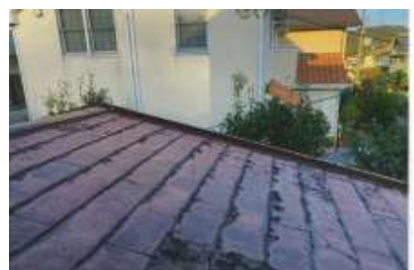
屋根材の腐朽(石綿セメント板)
