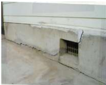
基礎のひび割れ
