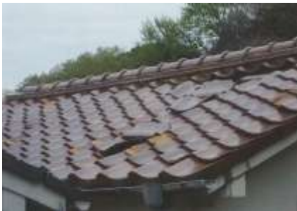
屋根瓦の剥落・ずれ
