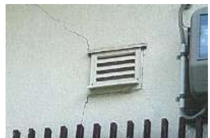
外壁のひび割れ
