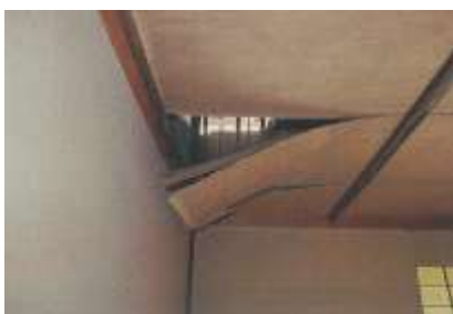
外壁破損による室内状況
