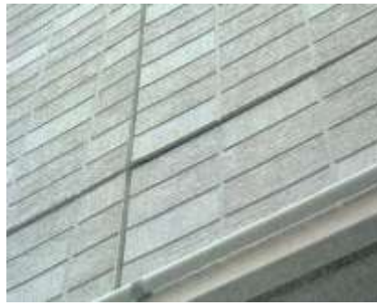
外装材の浮き
