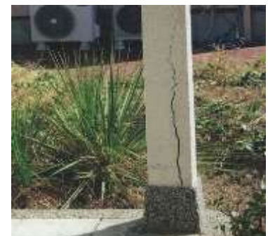
柱のひび割れ
