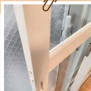
二重サッシ化やガラスの取替えは効果を実感しやすい改修項目の一つ
