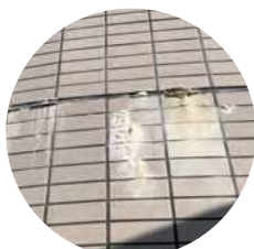
外壁タイル・シーリングの汚損
