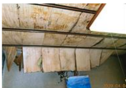
屋根破損による室内状況
