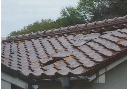
屋根瓦の剥落・ずれ
