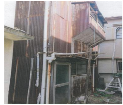
金属板の錆による腐朽
