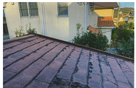
屋根材の腐朽(石綿セメント板)
