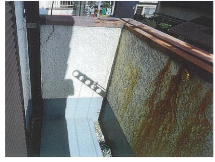
バルコニー腰壁のひび割れ・腐食
