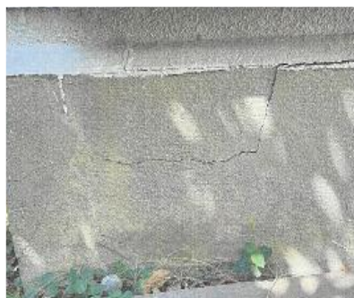
基礎のひび割れ
