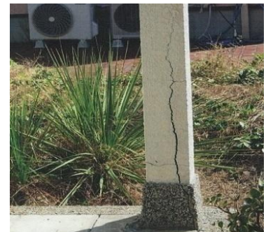
柱のひび割れ
