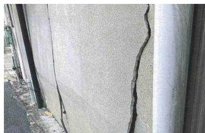
外壁のひび割れ・浮き
