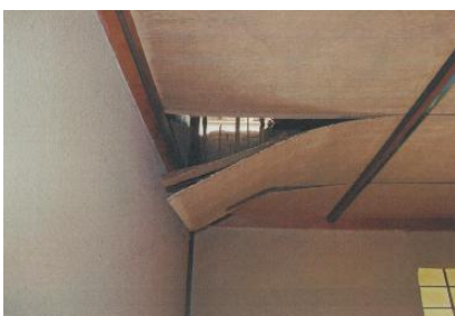
外壁破損による室内状況
