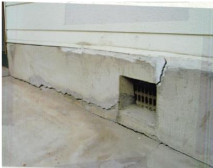
基礎のひび割れ
