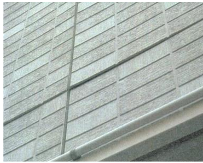
外装材の浮き
