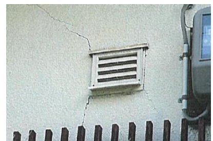
外壁のひび割れ
