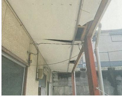
外廊下天井の剥落
