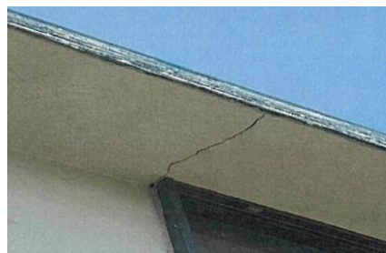
軒天井のひび割れ
