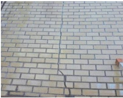
外壁タイルのひび割れ
