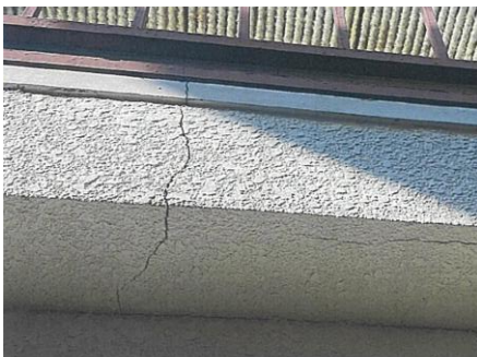
バルコニー軒先のひび割れ
